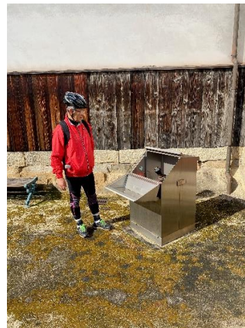
太田家住宅中庭の放水銃 ( (株) 福山管機工業設置 )
